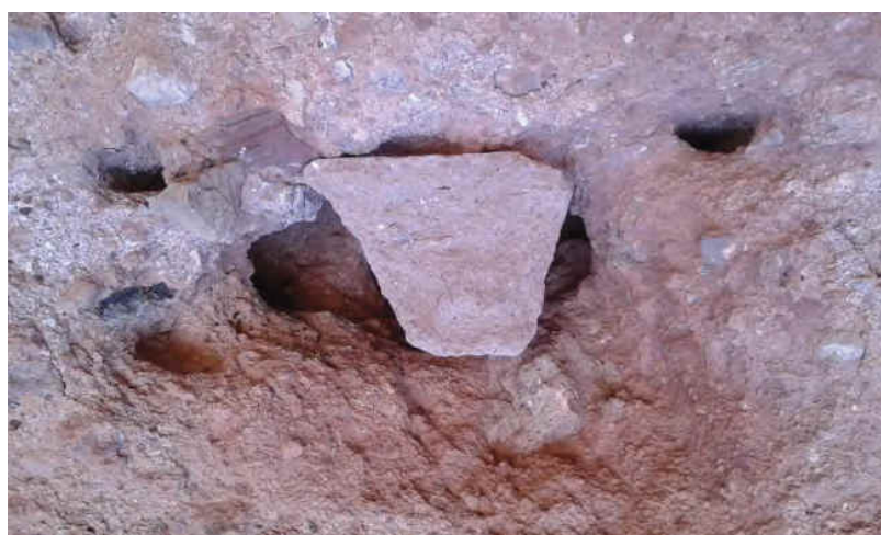
Figura 16. Trozo de muestra una vez seca contrastada con el paramento del muro noroeste (fuente: F. Castilla)
